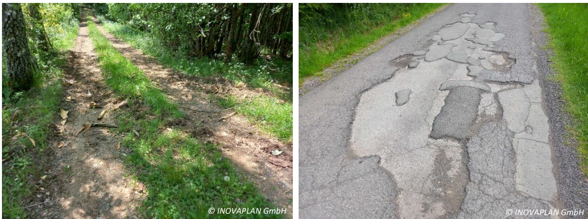
Abbildung 14 Wald-/Wiesenweg parallel zur L 149 nördlich von Nonnweiler (links); Schlagloch Braunschweiger Straße (Schwarzenbach – Bosen) (rechts) (Quelle: INOVAPLAN GmbH)
